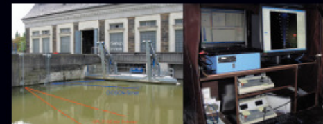
Versuchsaufbau zur hydroakustischen Erfassung von Aalen an einer Wasserkraftanlage (DIDSON und SPLIT-BEAM). Setup for hydroacoustic acquisition of fish at a hydropower station (combined DIDSON and SPLIT-BEAM).
